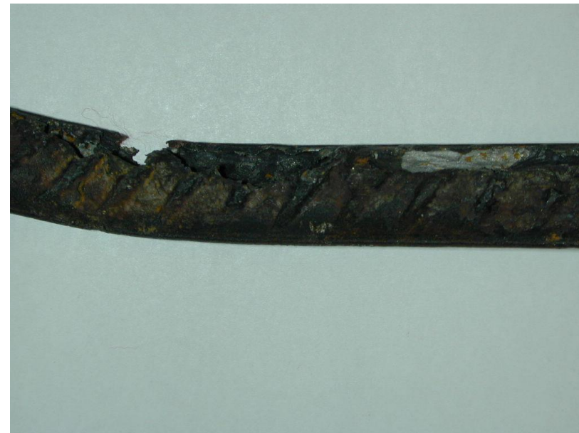
Coroziune de armătură inițiat de cloruri
